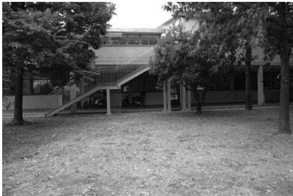
Le nuove scale antincendio
